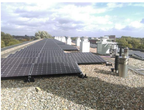
9 Zonnepanelen op etagewoningen.
